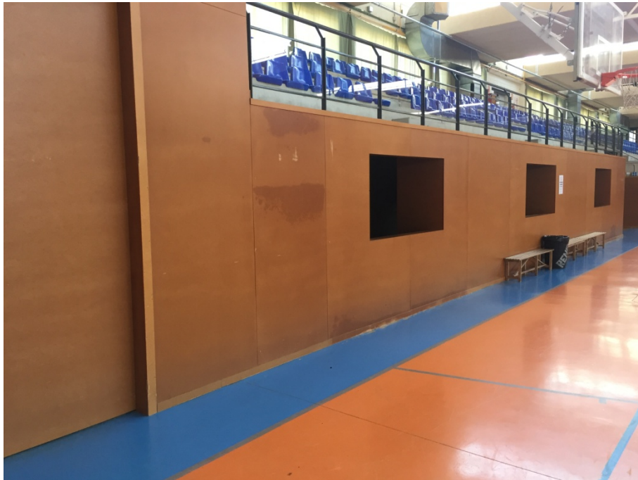
Vista panells fusta parament (S'observa humitats)
